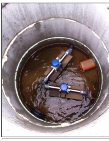
Billedet viser to af de flowmålere, der er sat i brøndene således at vi kan holde styr på hvor meget vand der infiltreres gennem den aktive randzone og hvor meget vand der bypasses direkte til vandløbet.
